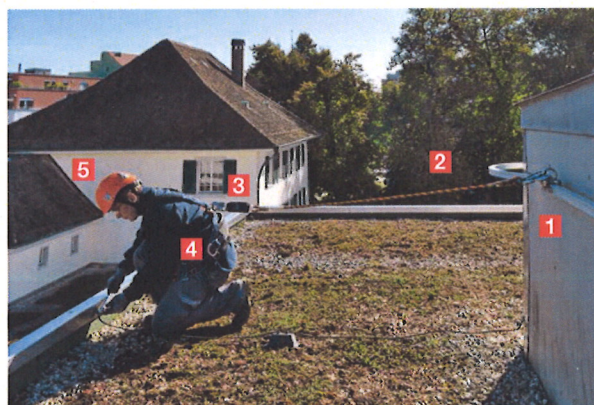
Fig. 11 Système de retenue sur un toit plat
