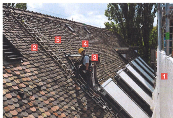
Fig. 12 Système de maintien au poste de travail sur un toit en pente
